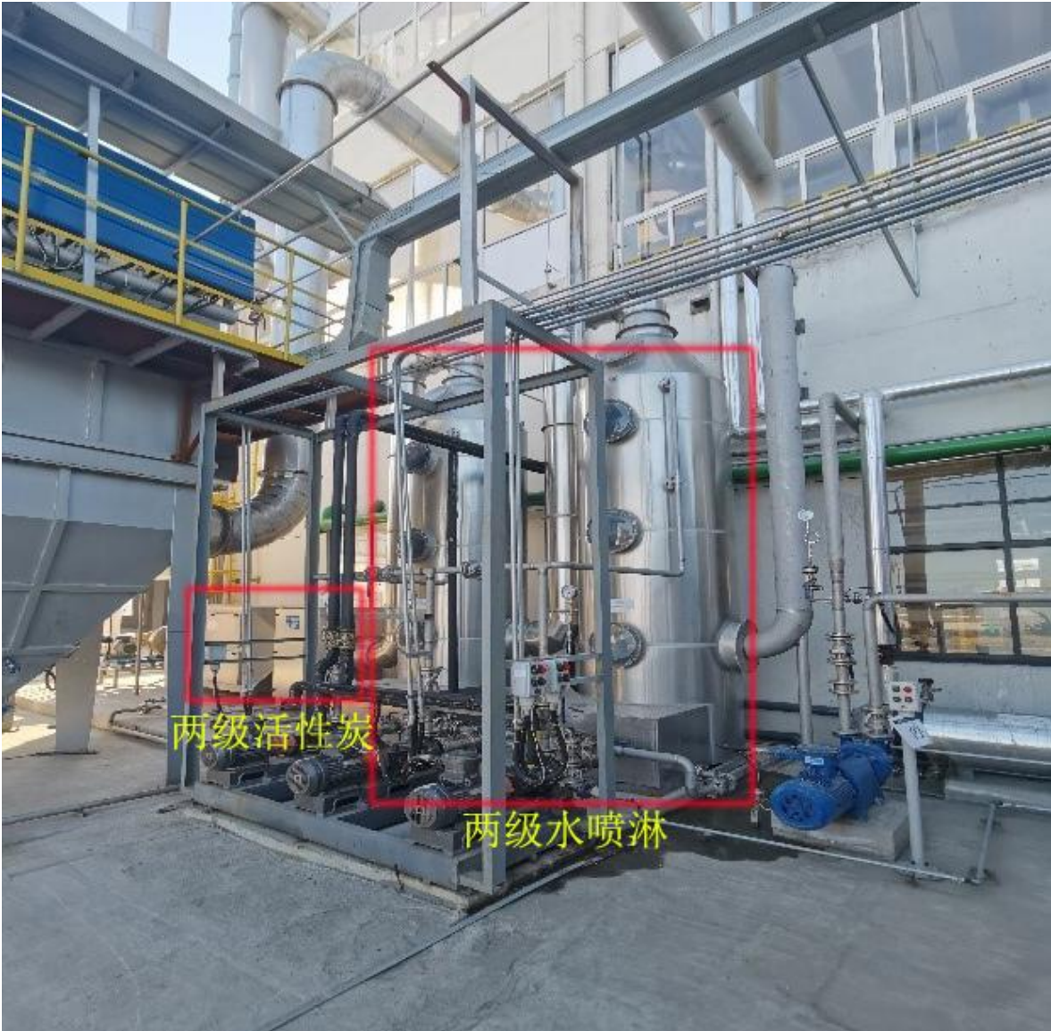
图 4-1 现有工程“两级水喷淋+除湿+两级活性炭”处理装置 表 4-7 现有工程“两级水喷淋+除湿+两级活性炭”处理装置相关参数
